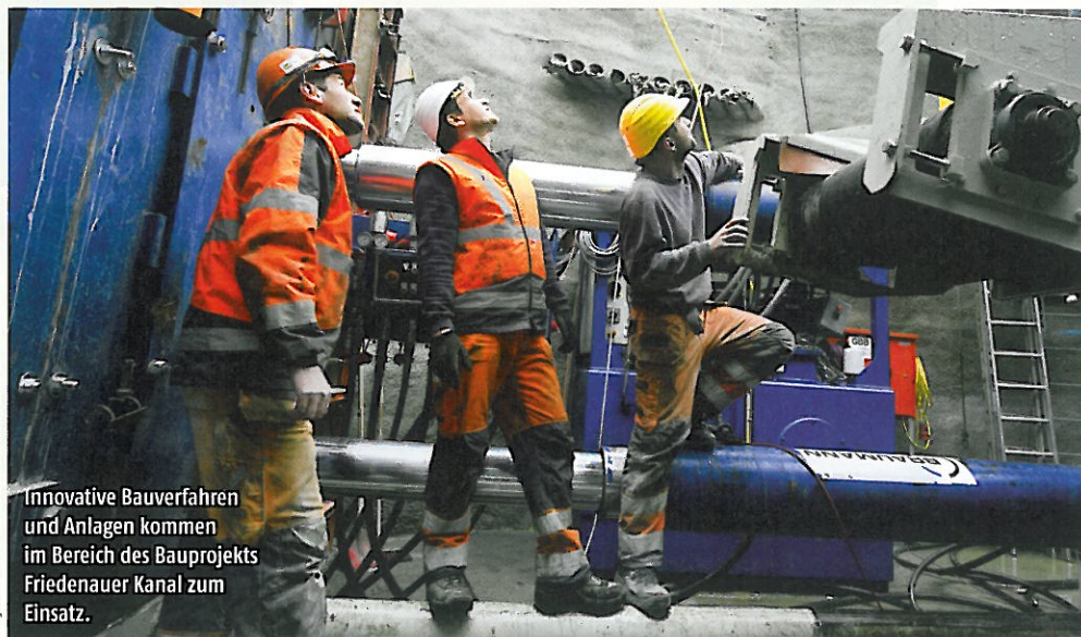
Benjamin Pritzkuhle/Berliner Wasserbetriebe
