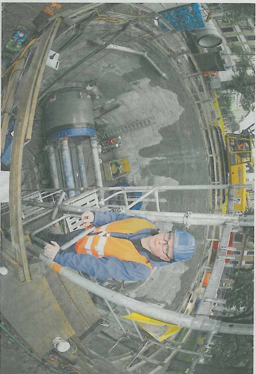
Hier hat alles gigantische Ausmaße: Die Startbaugrube für den Abwasserkanalbau am Kronstädter Platz ist sieben Meter tief und hat einen Durchmesser von elf Metern. Projektleiter Heiko Nytsch ist diese Größe gewohnt.
